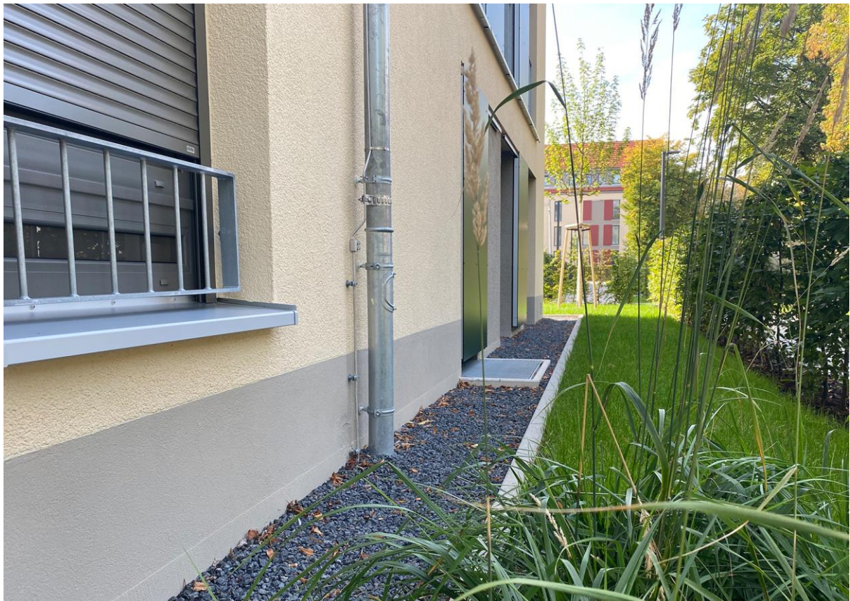
Abb. 2: Der neu eingeführte Anwendungstyp WAS in DIN 4108-10 trifft Regelungen für den spritzwasserbelasteten Sockelbereich. Diese Anforderungen werden von vielen PU-Dämmstoffen, die auch für Fassadenanwendungen und teilweise für WDV-Systeme geeignet sind, erfüllt oder gar übertroffen.
