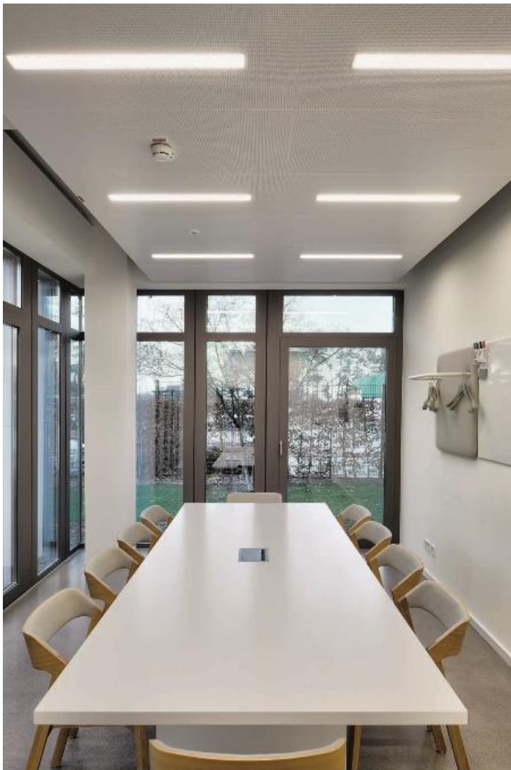
Abb. 3: Bei Bette wurden die Zehnder Deckensegel in 16 Büroräumen auf drei Etagen in einer Höhe von 2,83 bis 2,87 m und auf einer Deckenfläche von insgesamt 344 m 2 angebracht.
