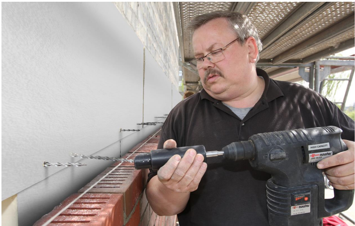
Bild 2: Die Anker werden gleichzeitig mit der Befestigung der PU-Dämmplatten beim Hochmauern der Verblendschale montiert. Foto: IVPU
