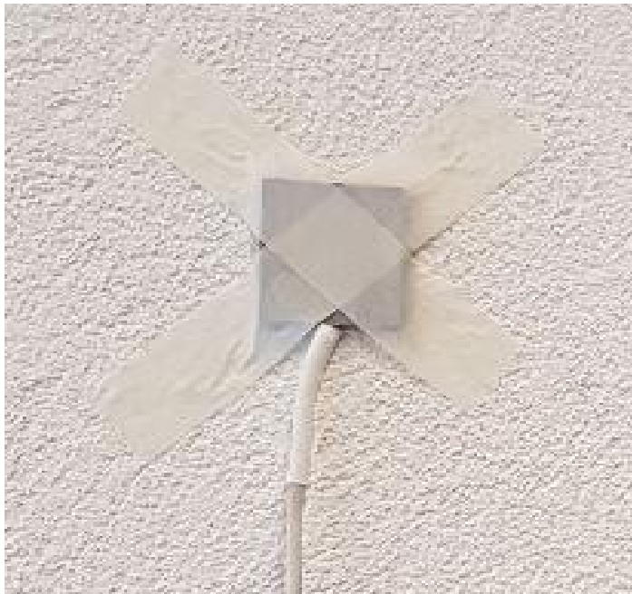
Bild 2: Mit dem Wärmeflussensor kann der U-Wert sicher bestimmt werden. © Foto: greenTEG AG
