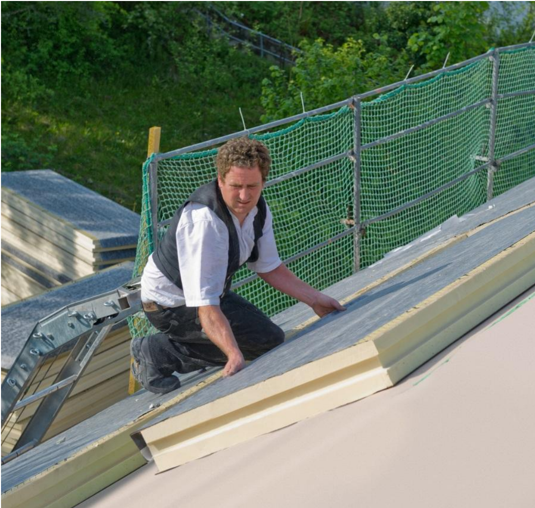
Bild 1: PU-Aufsparrendämmung: Energiesparend, feuchtesicher und wirtschaftlich © Foto: IVPU
