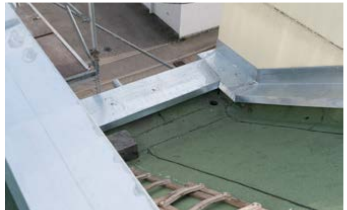
Attika-Gully dient als Notablaufsystem
