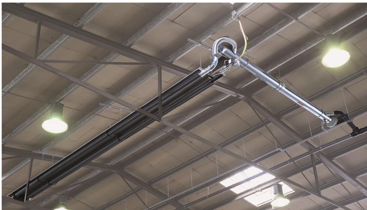
Bild 2: Durch optimale Nutzung der Restwärme erzielen GoGaS Dunkelstrahler, die mit dem Wärmeübertrager TRIGOMAX gekoppelt sind, höchste feuerungstechnische Wirkungsgrade. Foto: GoGaS
