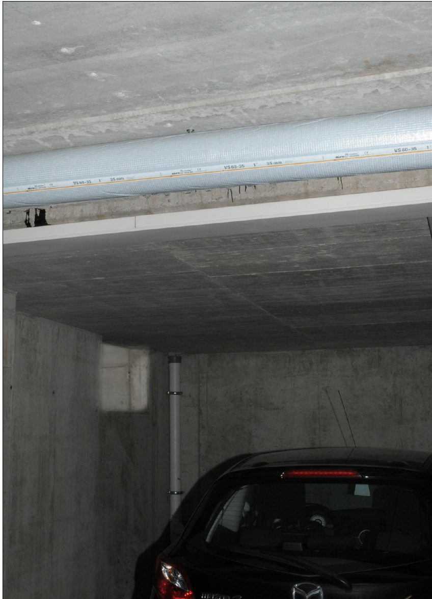
Bild 4: Typischer Einsatz der 200 Prozent-Dämmung in einer an Außenluft grenzenden Tiefgarage.
