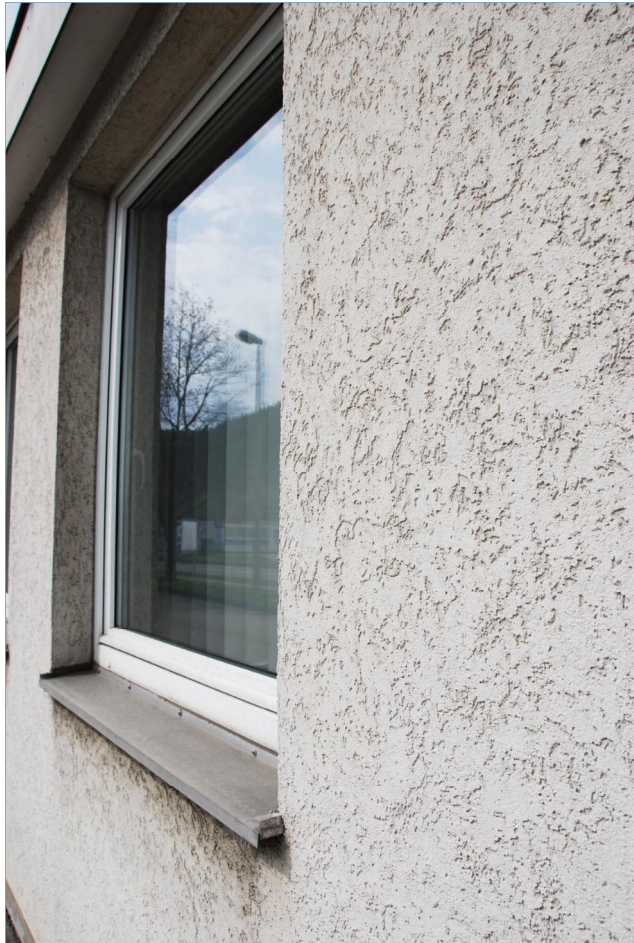
Bild 1: Das System hält – selbst an Fensteranschlüssen ist es ohne Mängel und daher noch voll funktionsfähig.
