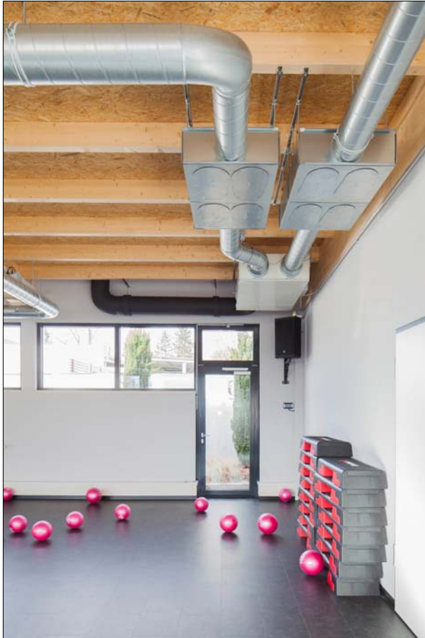
Bild 3: Für die Frischluftversorgung des großen Trainingsraums (siehe Bild) sowie der beiden Umkleiden- und Duschtrakte des Fitnessstudios wurden insgesamt drei Zehnder Großgeräte Maxi flat 600 installiert. Aufgrund der jeweils großen Kubatur der Räume und der hohen Personendurchlaufzahl fand Lüftungsexperte und Fachhandwerker Walter Fichtel in Abstimmung mit Zehnder in diesem Lüftungsgerät die optimale Lösung.
