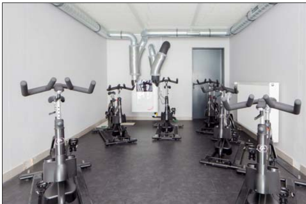
Bild 2: Walter Fichtel installierte im Friedberger Fitnessstudio das zentrale Komfort-Lüftungsgerät Zehnder ComfoAir Q350 TR. Dieses versorgt die Räumlichkeiten des 2019 eingeweihten „Kraftwerk 151“ konstant mit frischer Luft und sorgt so für stets angenehmes und gesundes Klima bei der körperlichen Ertüchtigung.
