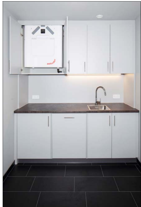
Bild 5: Die Mitarbeiterküchen des mobiheat Firmengebäudes ist so konzipiert, dass das Komfort-Lüftungsgerät von Zehnder in eigens gefertigten Küchenschränken „verschwindet“. Walter Fichtel empfiehlt seinen Kunden stets auch die Installation von Zehnder Enthalpietauschern, welche neben Wärme- auch optimale Feuchterückgewinnung ermöglichen.
